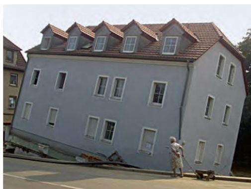
Abb. 8: Aufgeschwommener Estrich und gekipptes Haus durch unterspülen
